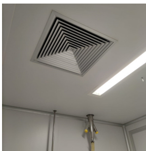
Figura 5: Sistema de insuflação de ar purificado nas salas. Fonte: Autores.
