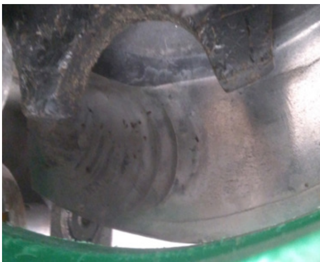
Figura 12: Chapa de passagem sem tratamento térmico. Fonte: Autores.
